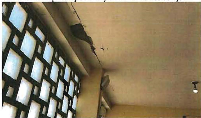
Slika 1. Karakteristična oštećenja: Pukotine u međuspratnoj konstrukciji i zidovima i oštećene betonske tranzene na fasadi.
